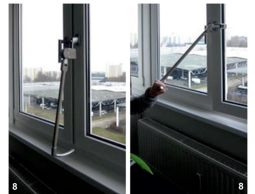
Greif-/Adaptionshilfen unterstützen das Öffnen von (zu hoch angeordneten) Fenstergriffen im Bestand
