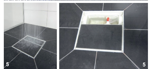
Barrierereduzierte Duschtasse (statt Badewanne) und in Duschfläche eingelassene Bodenablaufpumpe
